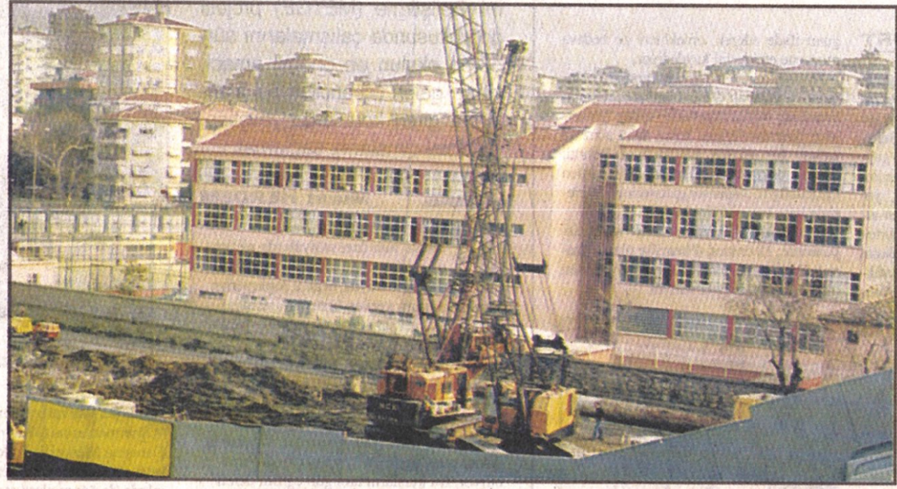
Kadıköy Ortaokulu'ndan Kenan Evren Lisesi'ne dönüşen okulun ek binası, son zamanlarda tehlike yaşıyordu...
